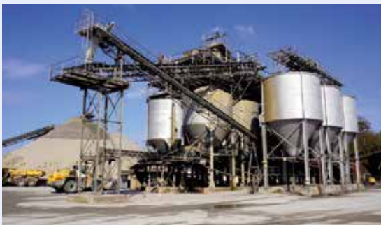
Nach der Klassierung und Säuberung der Gesteinskörnungen werden sie auf Halden oder in Silos zwischengelagert, von wo die Lieferkörnungen dann automatisch auf Lkws verladen werden, Foto: BGR.
